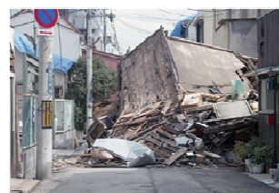
写真 建物の倒壊により閉塞した道路 出典：神戸市ホームページ
